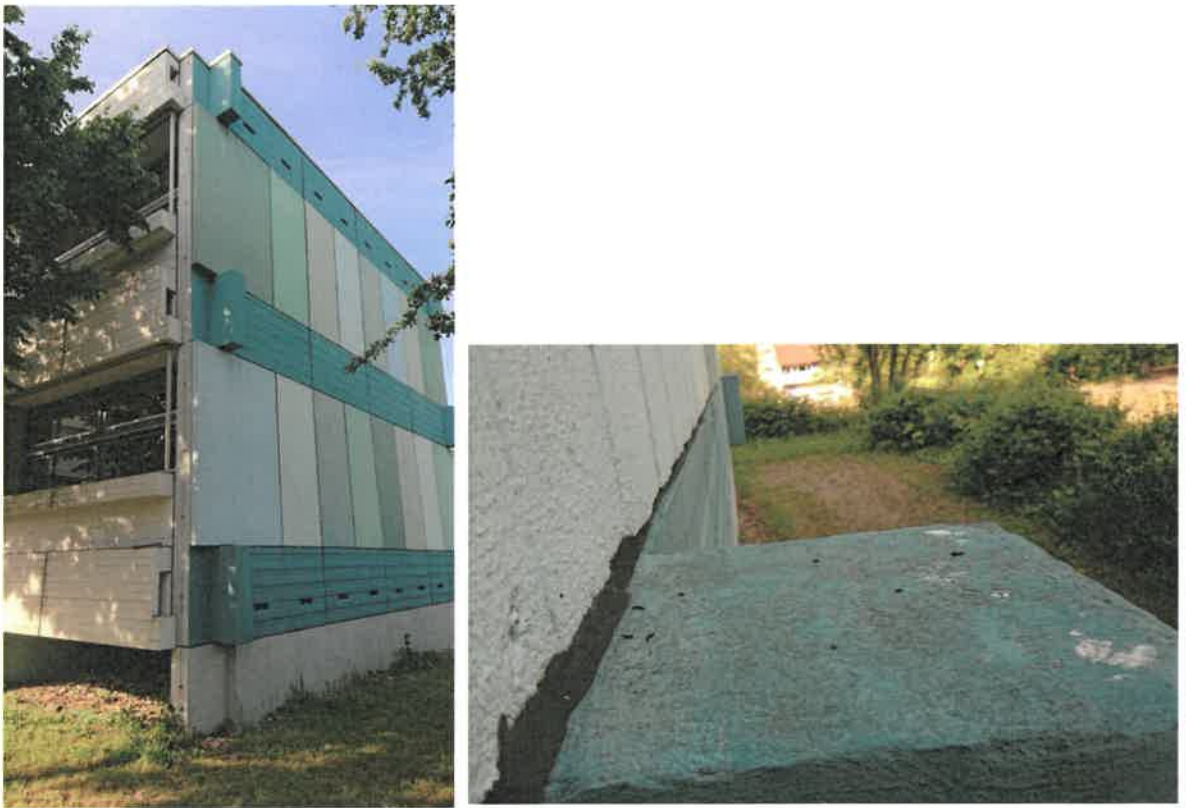
Abbildung 4: Südlicher Gebäudeteil der Realschule mit Fundort von Fledermauskot auf einem Fassadenvorsprung (rechtes Bild).
